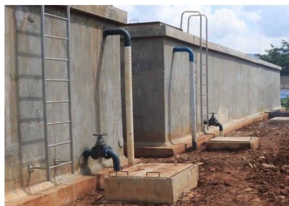
ถังเก็บน้ำ ความจุ ๕๐๐ ลูกบาศก์เมตร
